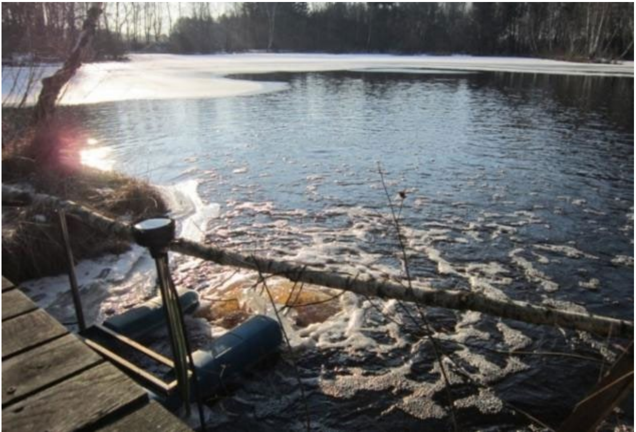
Die Pumpe sorgte in den Ziegeleiteichen für größere eisfreie Flächen, so dass ein Fischsterben verhindert werden konnte.
